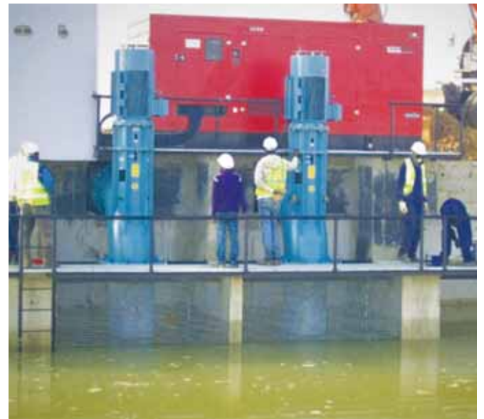
Pompes Chabot V 700 de 4 350 m 3 /h avec système de puissance et régulation dans une installation d'irrigation sur le continent africain
